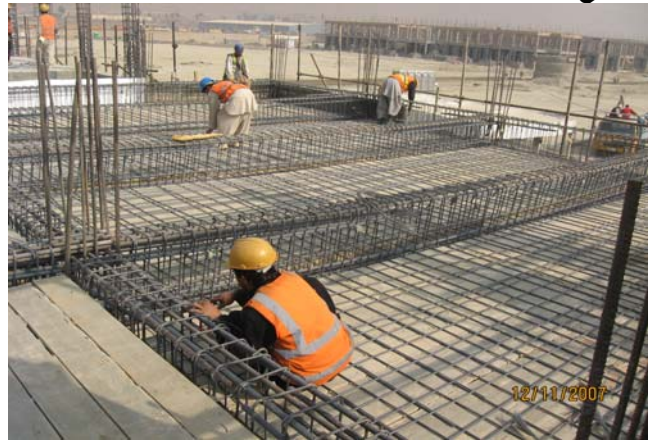
سیخ بندی بیم های منزل اول که در ساحه منفی آن فاصله بین دو layer سیخ ها مراعات شده است
