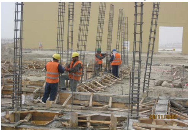
جا گذاری بستنی ها در موقعیت های مناسب ستون ها منزل دوم
