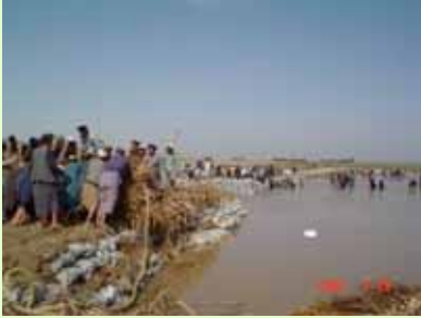
د ۱۳۸۳ کال د کب د مياشتې د سيمه ييزې ودې او پرمختيا د ملي پروگرام له خوا د کندز د کلاي ډال په ولسوالۍ کې د آمو سيند د غاړو د بېړني ساتندويه ديوالونو جوړول.
